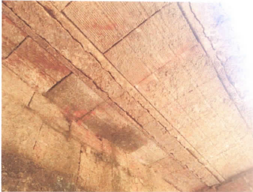
FOTO -05 (LAJE DA ARQUIBANCADA COMPROMETIDA)
