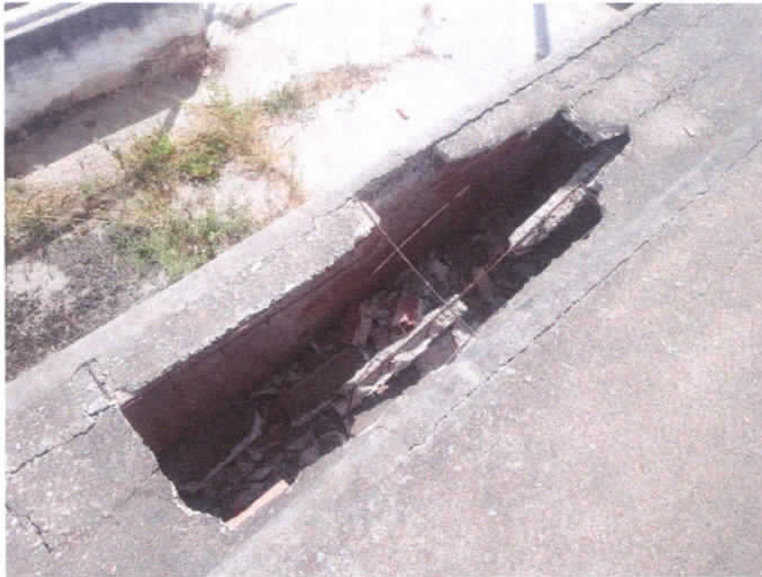
FOTO -06 (LAJE DA ARQUIBANCADA ROMPIDA)
