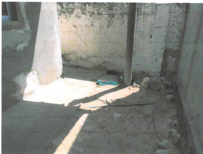
Imagem 3 – Caixa de passagem típica encontrada no local. Notar a presença de aberturas.
